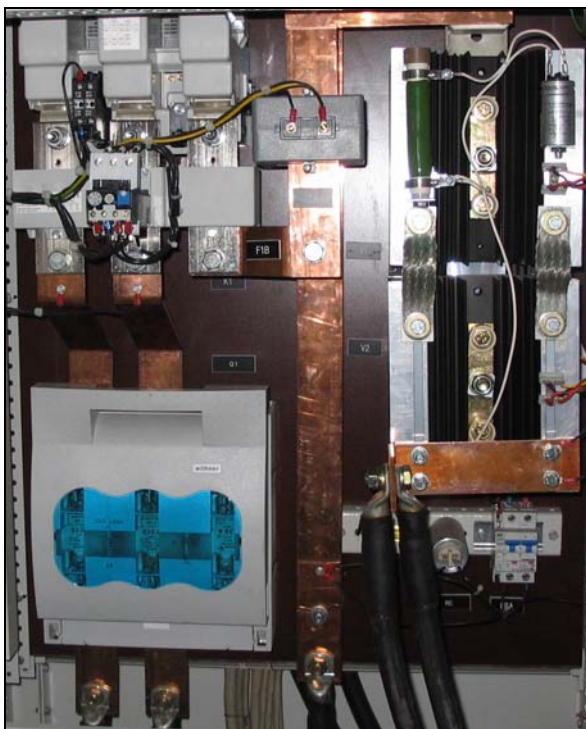
Slika 4. Energetski sklop upravljačke jedinice elektrofiltera
